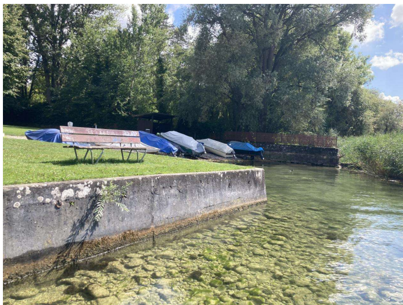
Abbildung 19: Ufermauer und Bootsanlegeplätze auf der Parzelle 74.
